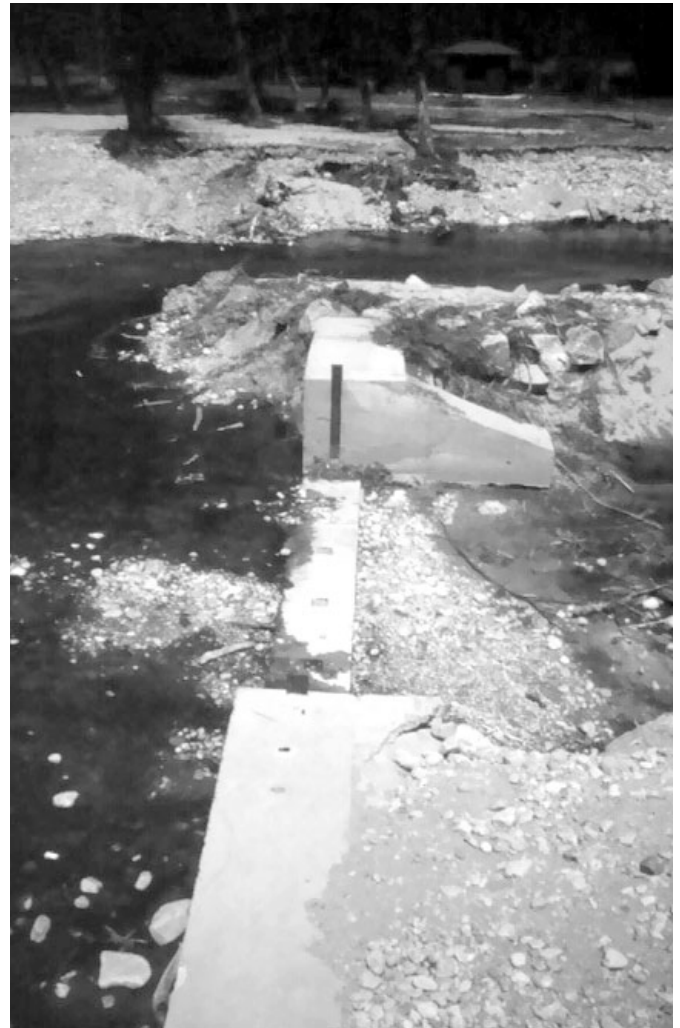
Photo 2 : Structure pour baignade de Désaignes après la crue Photo L. Maillou
