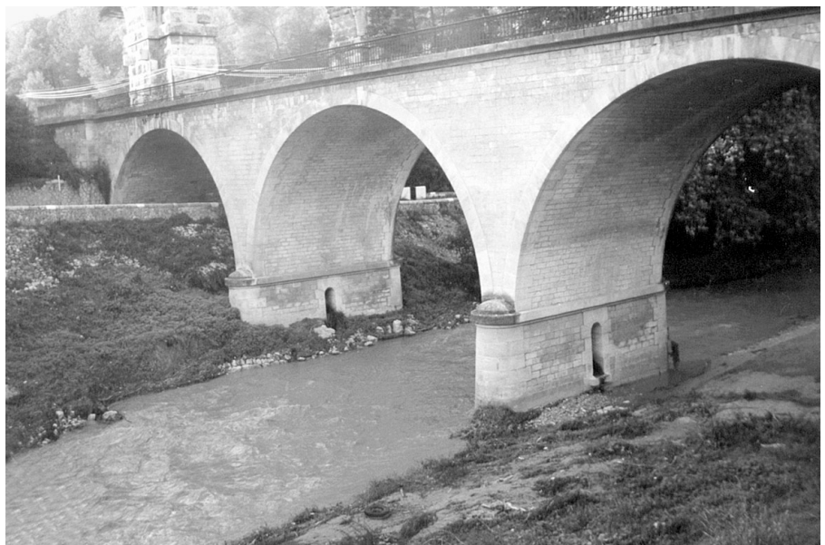
Photo 1 : Crue de l'Arc, le 17 janvier 1999 - Ventabren Roquefavour
