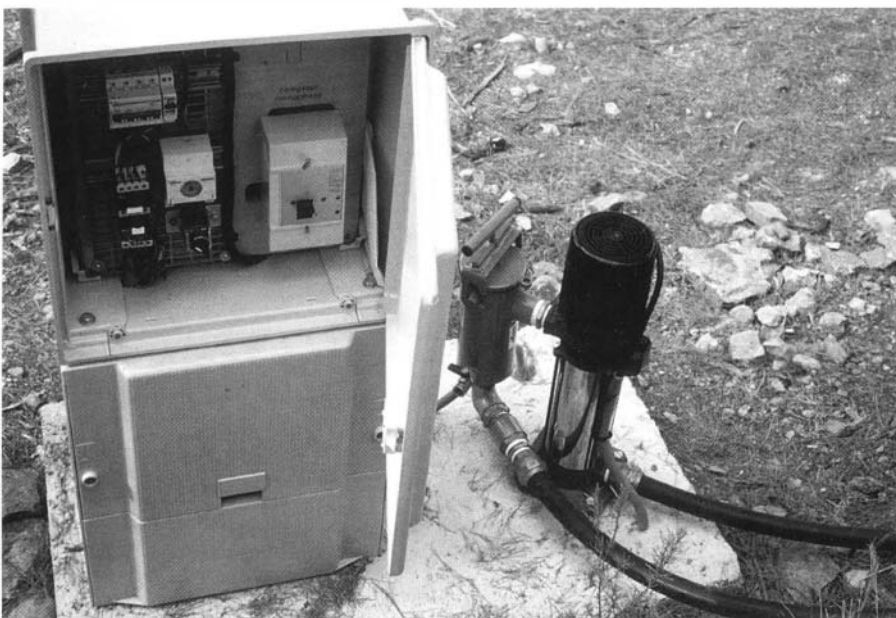
Site de Ceyreste : Alimentation électrique et station de pompage.
