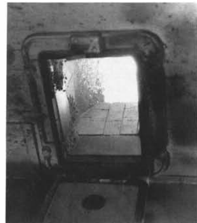
La bouche du tambour sécheur. Photo D. L.
